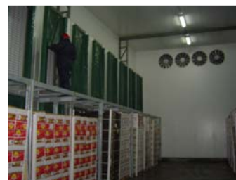
Vista interior Cámara Solfrut
